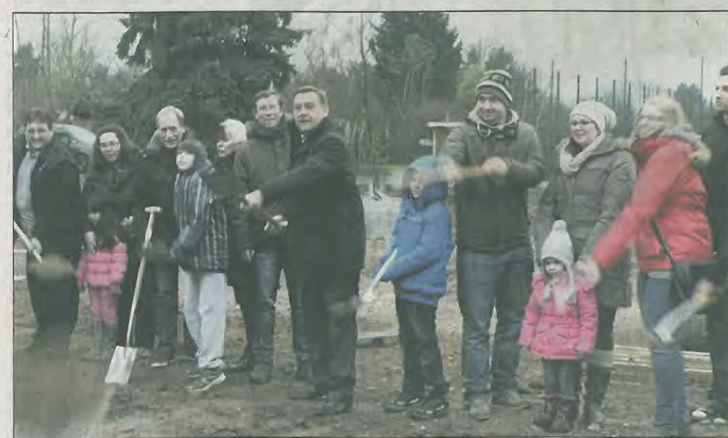
Nachdem die maroden Wohnblocks am Goldacker in Klein-Auheim abgerissen wurden, fand dort nun der Spatenstich für das Neubau-Projekt statt. ▪ Foto: Stadt
